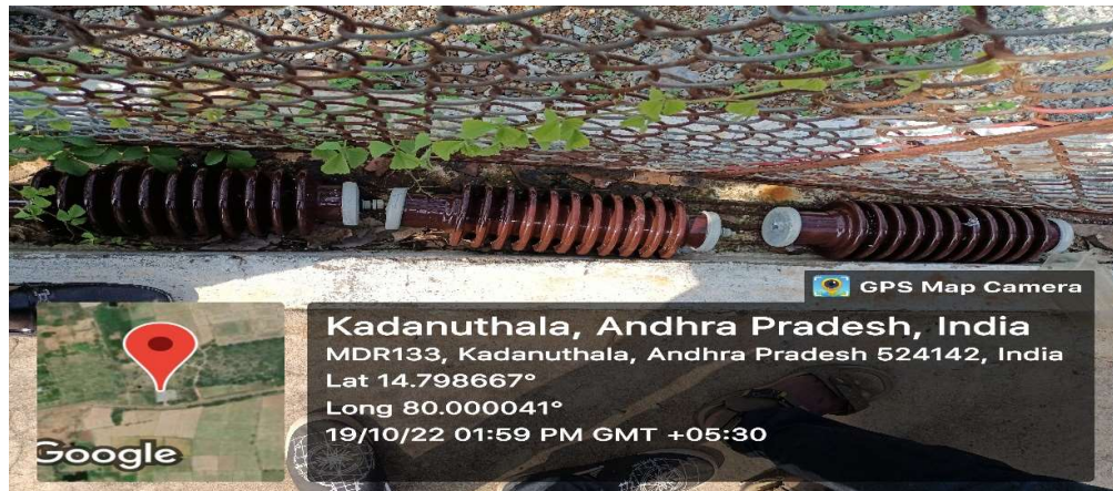
FIG: LIGHTNING ARRESTOR
